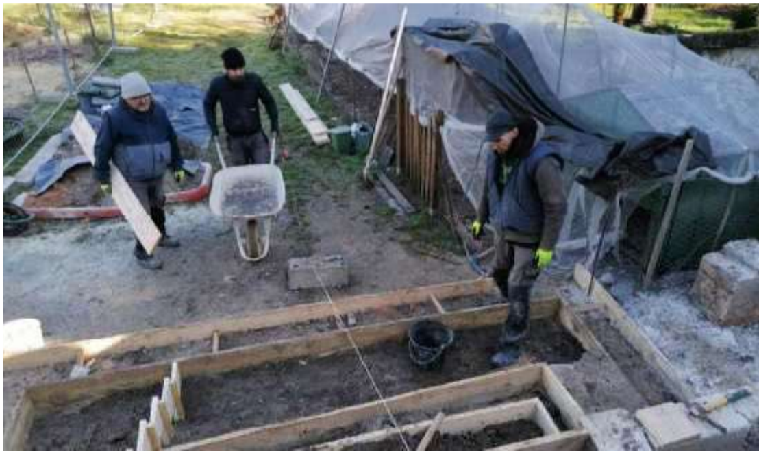
L'escalier rénové passera de 25 à 35 marches, plus profondes et moins hautes. S.J.
